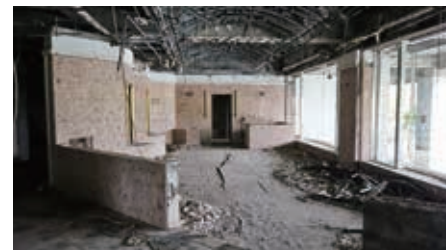
鉄筋コンクリート製の建物に15m以上の津波が直撃した民間震災遺構「高野会館」
